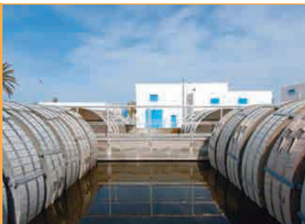
Exemple de disques biologiques, station d'épuration de Kerkannah, Tunisie
