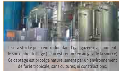
Le captage de l'eau de Didier à une profondeur de 3 mètres. Le tuyau de droite recueille une partie du gaz carbonique présent naturellement dans l'eau...
