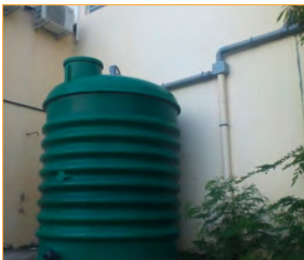
Réservoir de récupération de l'eau de pluie
