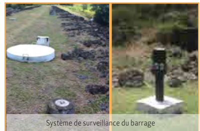
Système de surveillance du barrage
